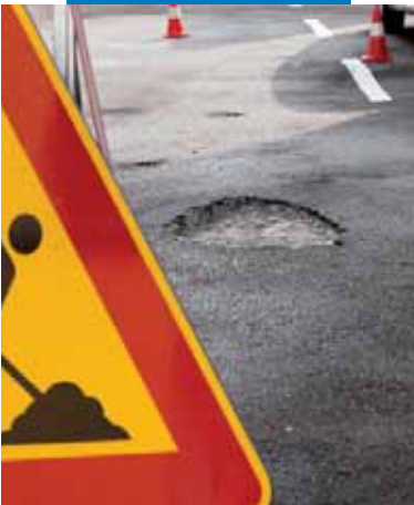
Silniční výtluk připravený k opravě
